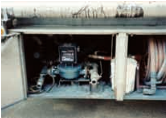
写真 スラリーポンプ
